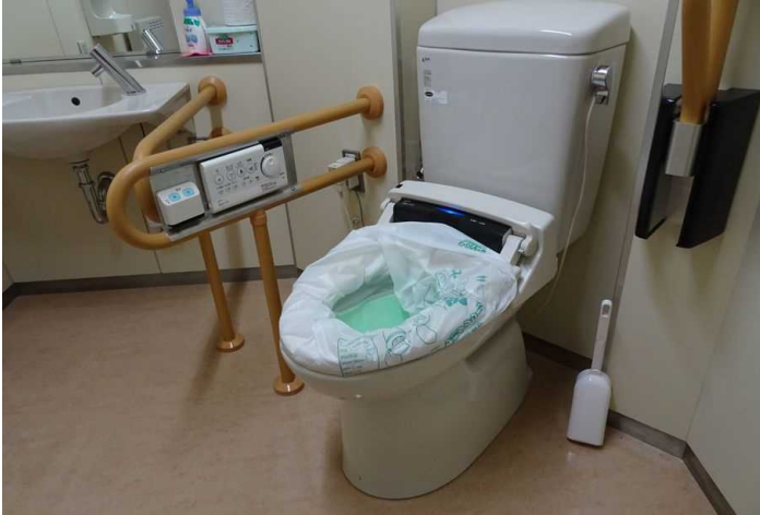
簡単トイレをかぶせた青葉会館多目的トイレ
